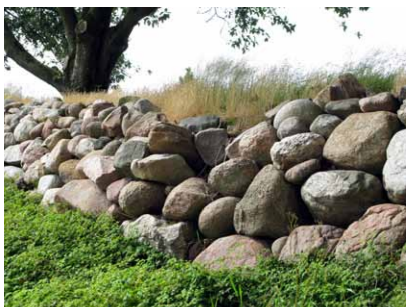
Den udvendige side af syddiget trænger til snarlig restaurering
